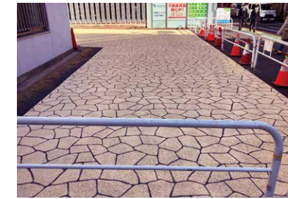
▲一気に明るくなった広場。工事現場に投票結果を掲示して、住民が選んだことが分かるようにした。
